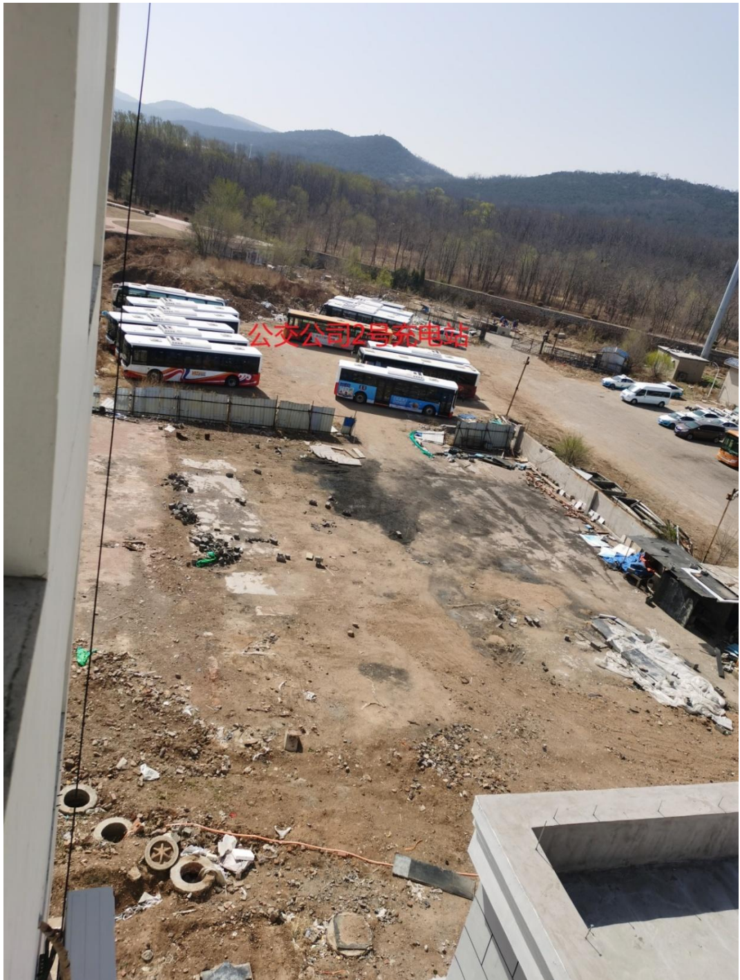
图 5-21 葫芦岛公交公司 2 号充电站
