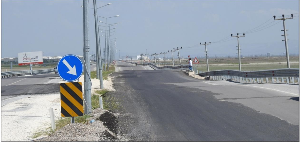
Şekil 19. Hatay Havalimanı Yolunun Deprem Sonrası Görünümü (Km:2+840-3+480)
