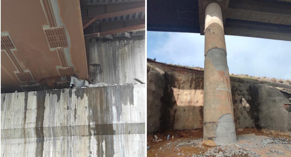
Şekil 5. Mesnet ve Ayak Hasarları - Nurdağı Viyadüğü
