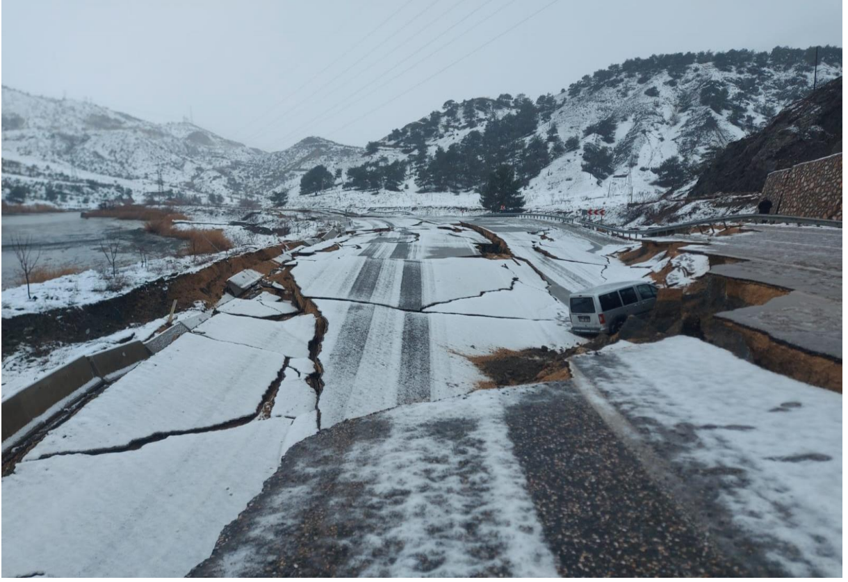
Şekil 31. Trafo Bölgesindeki Hasar (Malatya-Gölbaşı Yolu KM:89+260-KM:30+100)
