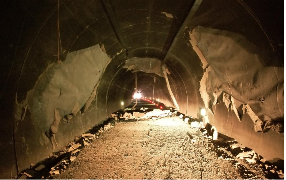
Şekil 32. Erkenek Tüneli Giriş Portal Bölgesindeki Hasar
