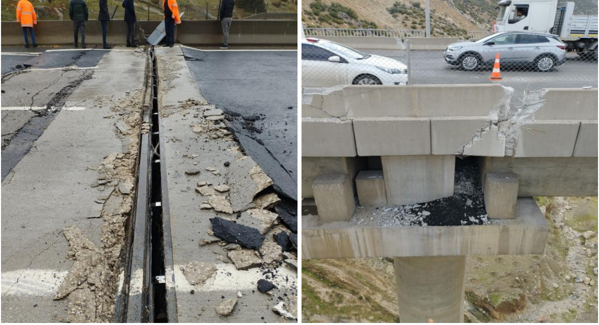
Şekil 6. Deprem Hasarları – Başpınar Viyadüğü
