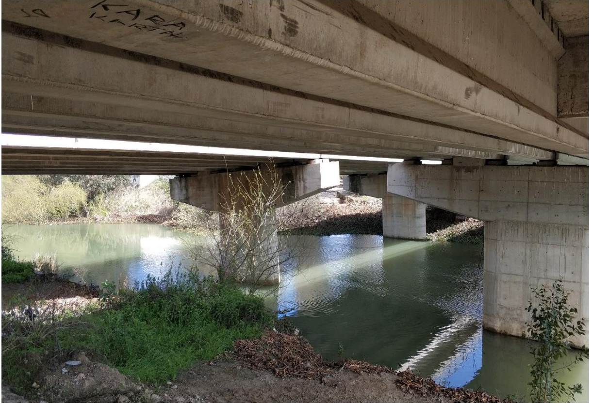
Şekil 13. Demirköprü Ayaklarındaki Hasar
