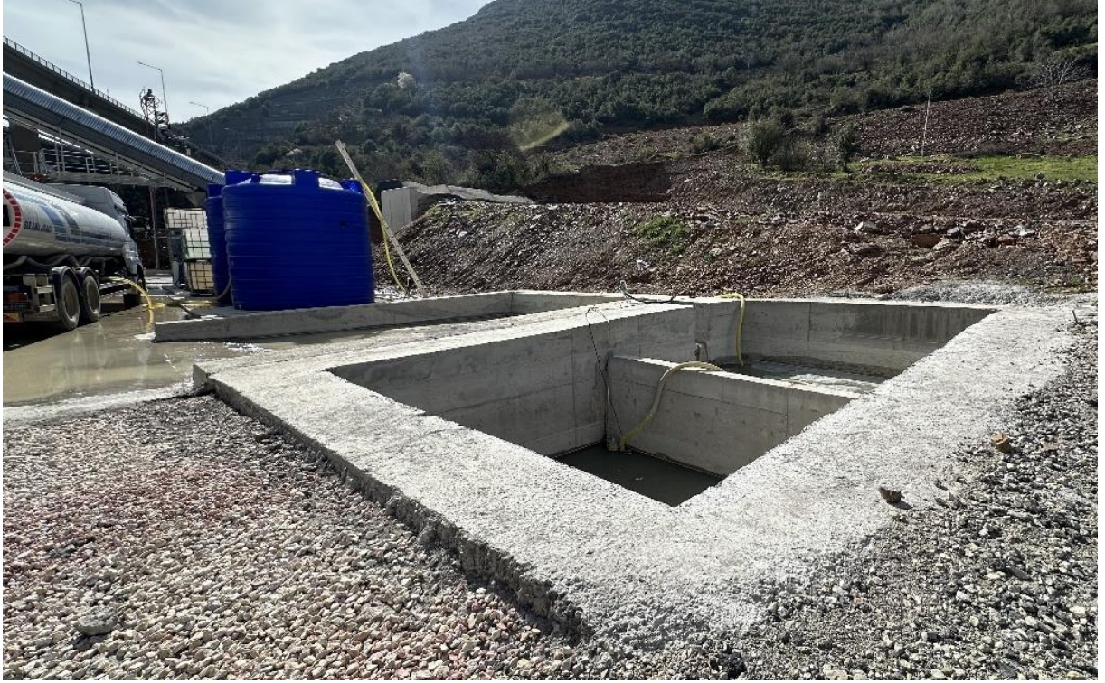
Şekil 9. Bahçe Ayran Beton Tesis Kademeli Çöktürme Havuzu
