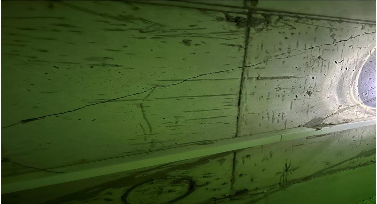
Şekil 36. Kılcal Kesme Çatlakları
