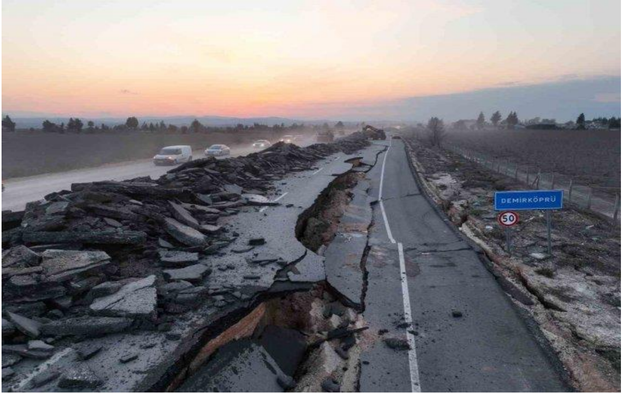
Şekil 14. Demirköprü'nün Depremden Sonraki Görüntüsü
